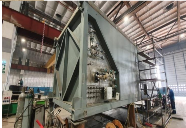
Constructions métalliques REKTI & HEX Box, projet Kedainiai Lituanie Client: Linde AG Période: Mars - Sept.2019
