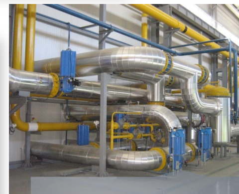
Departament Instalații Criogenice
