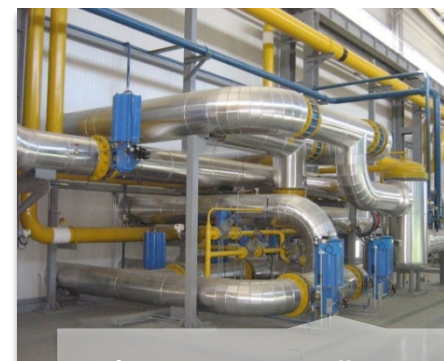
Département Installation Cryogéniques
